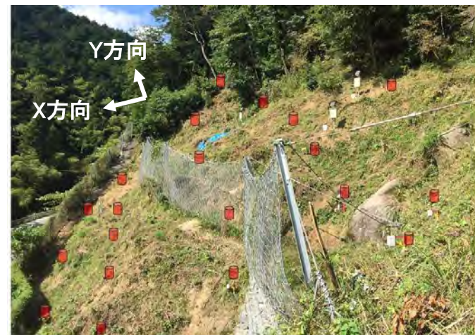
多点配置した斜面崩壊センサー
