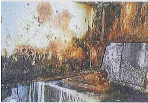
写真1 支点部周辺の腐食
