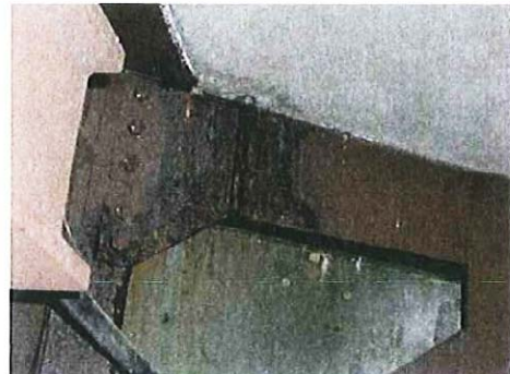
写真4 耐候性鋼橋梁端横桁の層状はく離さび
