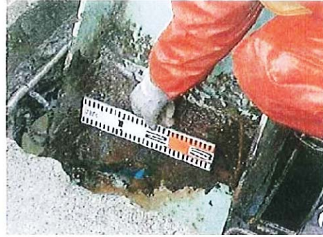
写真2 トラス橋斜材のコンクリート床版貫通部の腐食
